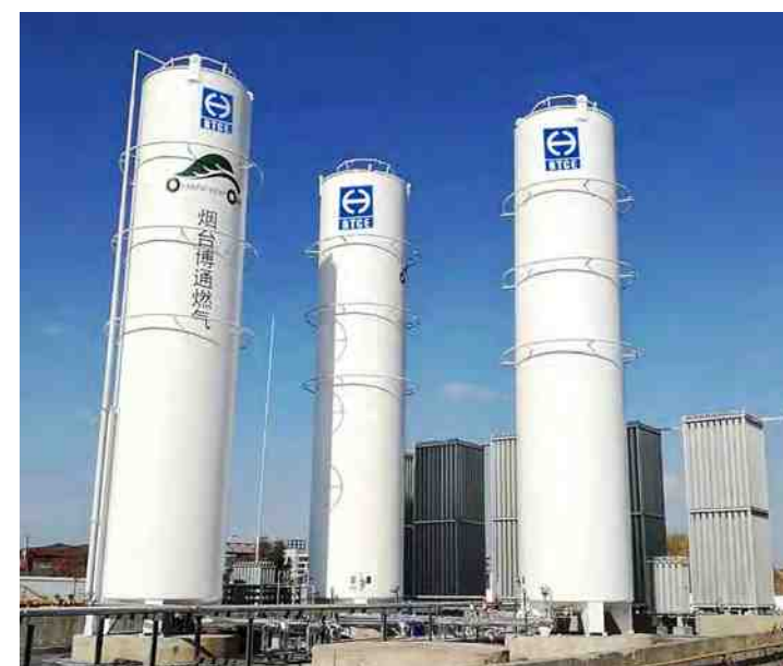
LNG气化站 LNG Gasification Stations
